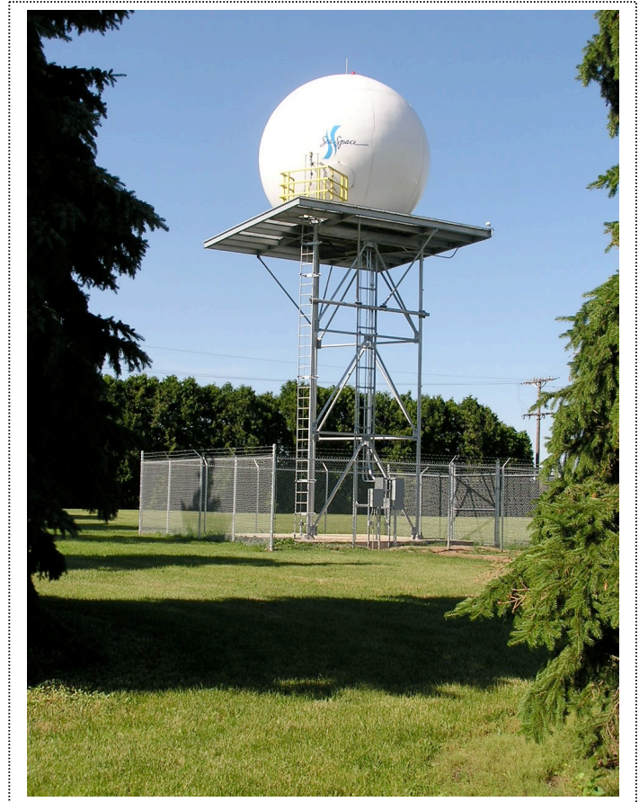
PTO 4.5 m. tracking antenna/radome on 9 m. tower
